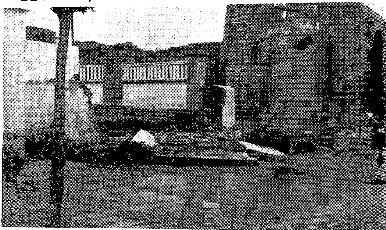
La violencia de las aguas que descendían rompieron en Tarifa este muro y le dió vía libre para que anegaran totalmente la ciudad, creando una situación dolorosa para muchas familias, que pasaron un trance difícil ante la altura que iban alcanzando las aguas. (Foto Naranjo)
