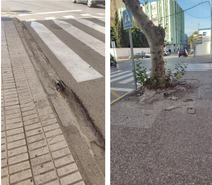
Figura 69. Mal estado del acerado en Av. España (izquierda) y C. Gibraltar (derecha)
